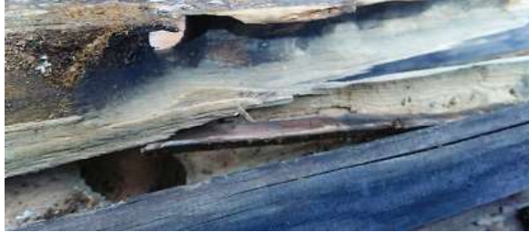
↑ ハチの巣で内部が空洞になっています
